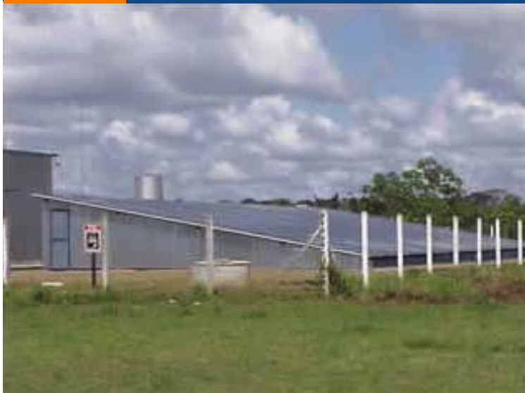
FIGURA 3.13 Sistema híbrido solar-diesel de Araras, Nova Mamoré – RO
