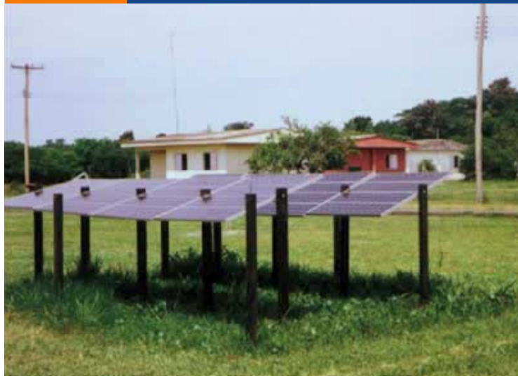
FIGURA 3.11 Sistema de eletrificação fotovoltaica do Núcleo Perequê (Vale do Ribeira – SP)
