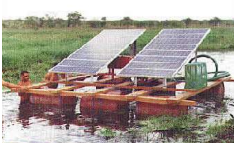
FIGURA 3.9 Sistema fotovoltaico de bombeamento de água para irrigação (Capim Grosso – BA)
